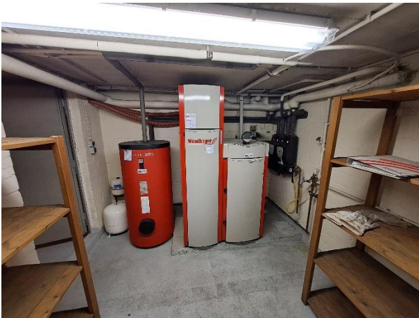
Keller Heizungsraum Pelletheizung
